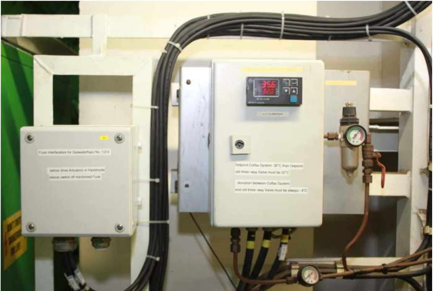
Verdrahtungsbox (links) für die Sensoren der CM-1000-Anlage. Kontrollbox (rechts) für den Reglerantrieb des Dreiwegeventils in der ursprünglichen Regelung der LT-Kühlwasseranlage. Auf der Kyoto Express liegt dessen Setpoint immer 4 °C unter dem Setpoint der CM-1000. Das stellt sicher, dass sich „alte“ und „neue“ Regelung nicht gegenseitig beeinflussen.
