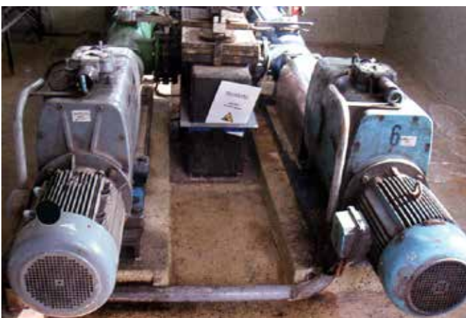
Installation vor der Beratung
